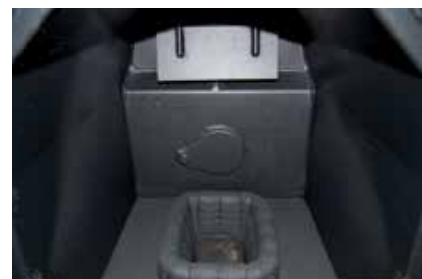
Cámara de combustión
